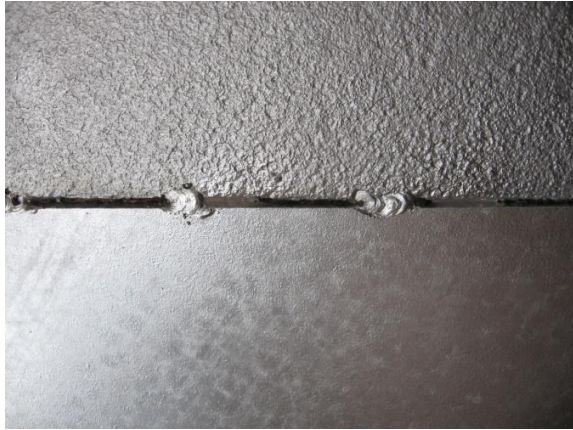
40. kép: „Vakrozsdás” felületen kialakult horganyréteg (felül)
