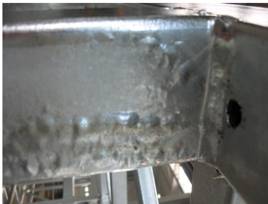
57. kép: Horgany megfolyás a nem megfelelő helyre fúrt technológiai furat miatt
