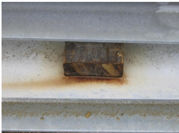
53. kép: Szennyezett alátétfa következménye felületszennyezés
