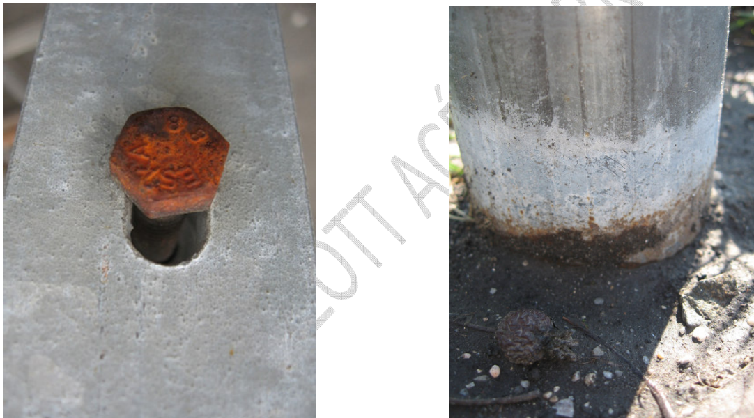
1-2. kép: Galvanikusan horganyzott és tűzhorganyzott elemek (balra) és vékonybevonatos acélcső korróziója
