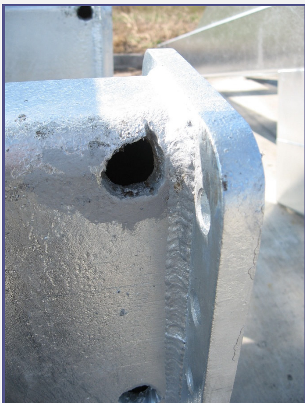
Egy utólag „készített” technológiai nyílás kifogásolható minőséget eredményezett
