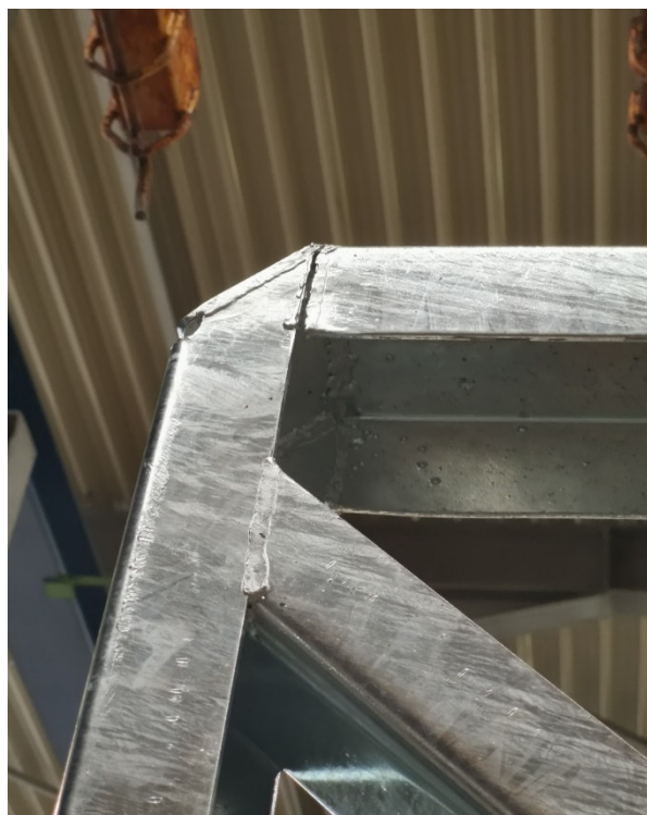
6. kép: Dilatációs feszültség okozta hegesztési varrat szakadás (fent)
