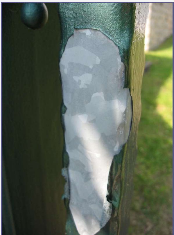
Rosszul kivitelezett duplex-bevonat
