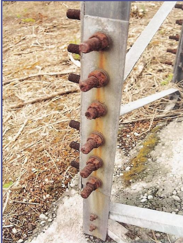
Nem tűzhorganyzott kötőelemek előrehaladott korróziója tűzhorganyzott acélszerkezeten
