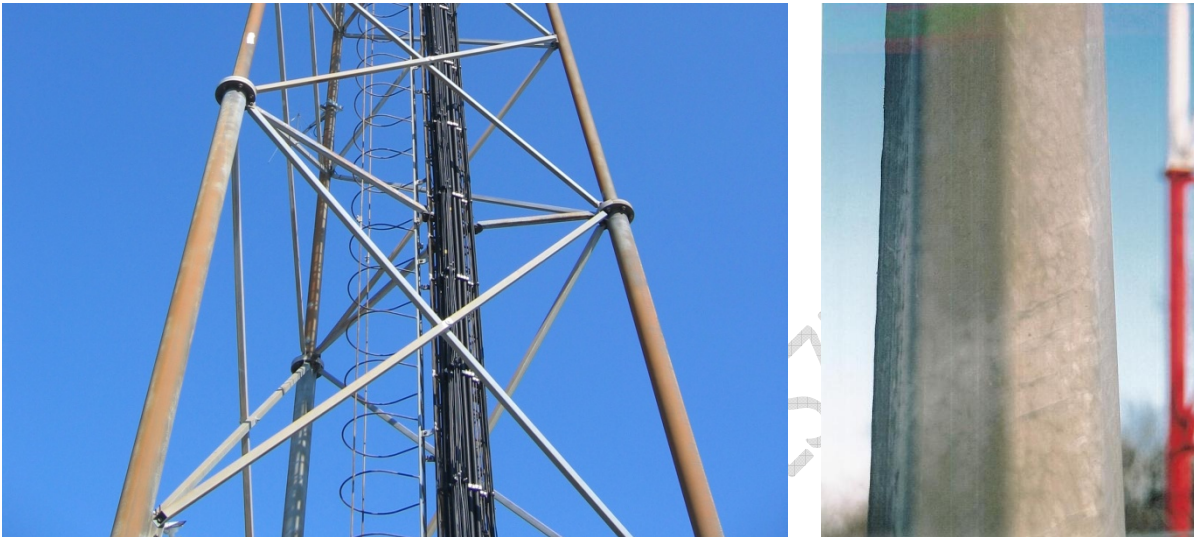
1-2. kép: A bevonat rozsdabarna elszíneződése nem tűzihorganyzási hiba
