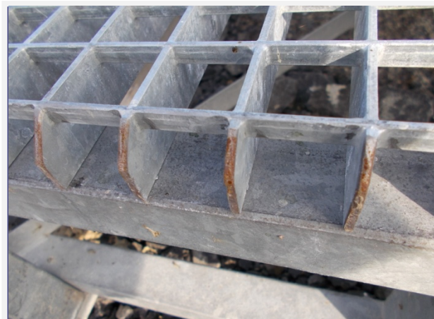
A cink katódos védőhatása a járdarács termékeknél is érvényesül (képen egy elvágott rácsszél)
