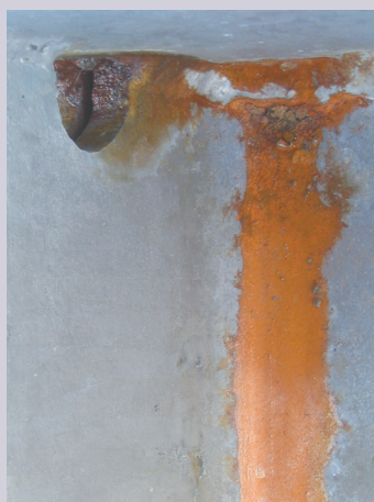
Kifolyások, szivárgások tűzhorganyzott felületen
