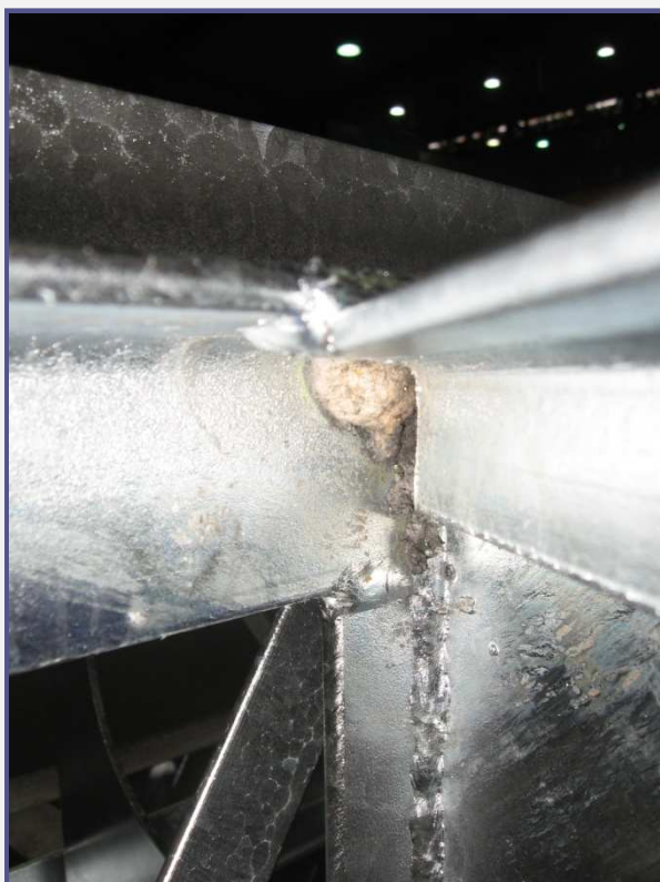
A szögacél sarkánál elmaradtak a technológiai nyílások, mely légzsákhöz vezetett.
